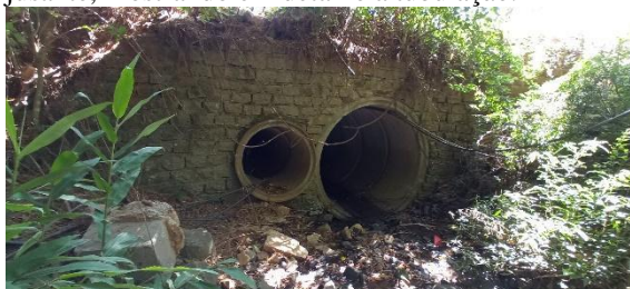
Figura 75: Vista do PA 04, localizado a montante da Av. Luizz Spolti, com sentido de montante para jusante, mostrando em detalhe a tubulação.
