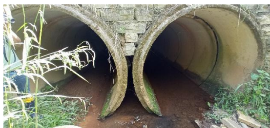
Figura 90: Vista do PA 11, localizado a montante do perímetro urbano. Saída da tubulação, é possível visualizar a quantidade de material dentro da tubulação da esquerda da fotografia.
