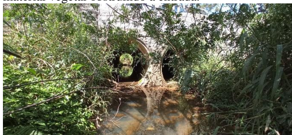
Figura 89: Vista do PA 11, localizado a montante do perímetro urbano. Vista da tubulação do PA11, de montante para jusante. Percebe-se a quantidade de material vegetal obstruindo a entrada.
