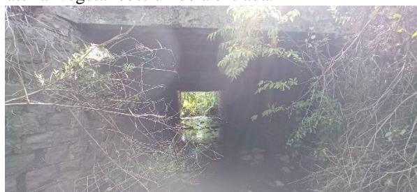
Figura 98: Vista do PA 11, localizado a montante do perímetro urbano. Vista da tubulação do PA11, de montante para jusante. Percebe-se a quantidade de material vegetal obstruindo a entrada.
